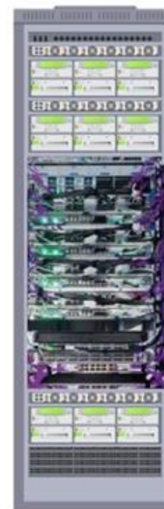
AI Server system由外部 Power Shelf / BBU 供電48Vdc
